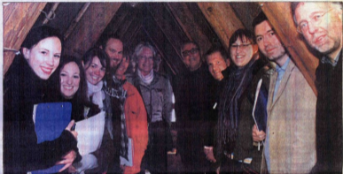
Bei ihrem gestrigen Besuch in Celle nahmen Studenten der HAWK Hildesheim auch den Dachstuhl des Hauses Schuhstraße 5 in Augenschein. Foto: Möller
